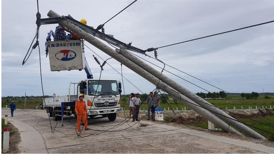
Hình 2. 5: Giông bão gây đổ cột điện
