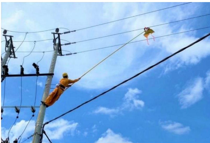
Hình 2. 2: Công nhân điện lực gỡ diều mắc phải ĐZ
